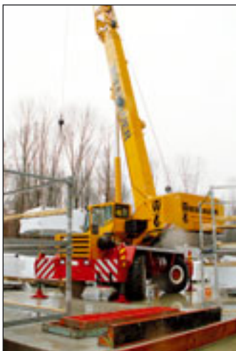
Der Grove RT 600 E hilft beim Fassadenbau der neuen Zentrale der EnBW in Stuttgart
