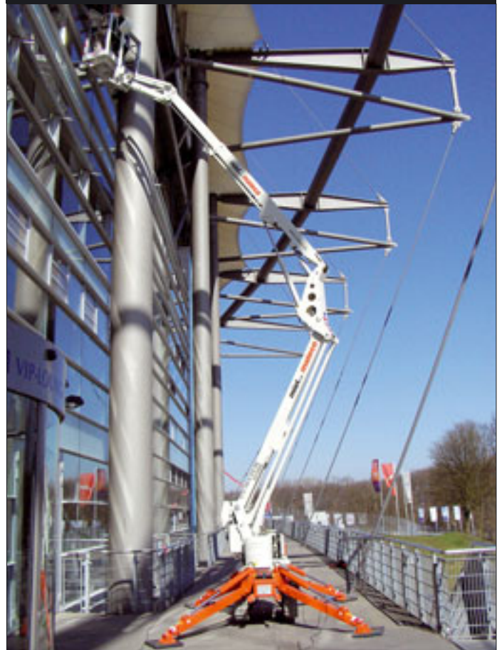
Eine Teupen LEO 15 GT setzte Mateco bei Arbeiten an der AOL-Arena in Hamburg ein
