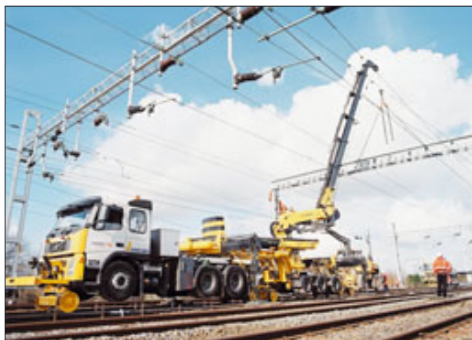
Das größte Zwei-Wege-Fahrzeug weltweit wurde jüngst in England in Betrieb genommen. Aufgebaut auf einem Sattelzug, ist dieser PKR 750E im Fahrleitungsbau im Einsatz. Der Knickarm lässt sich um bis zu 80 Grad überstrecken.
