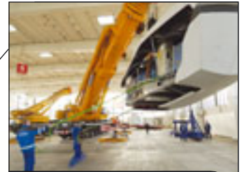
Tonnenschweren Großexponate wurden auf der internationalen Fachmesse WindEnergy 2004 in Hamburg gezeigt. Rund 90 Tonnen schwer sind Gondel und Nabe des 2-MW-Flaggschiffs MM82/2MW des Herstellers Repower, die am Haken des Krans von Knaack hängen. Bild HMC / Romanus Fuhrmann-Rickert
