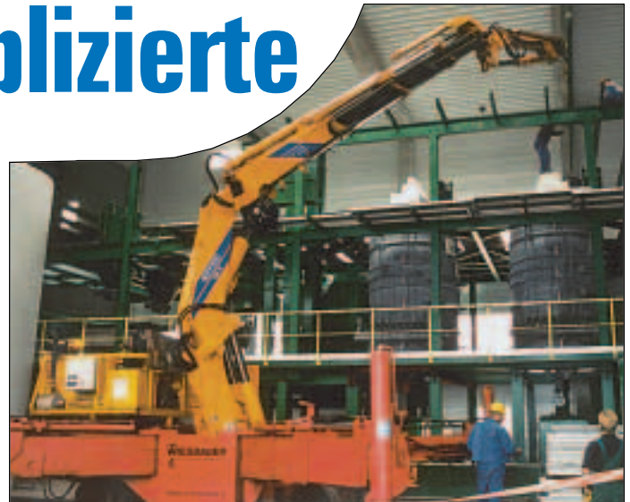
Auch für enge Platzverhältnisse bietet Engel-Krane Lösungen an. Für diesen Spezialeinsatz wurde der WEMB 108 von Wiesbauer aus Bietigheim eingesetzt.
