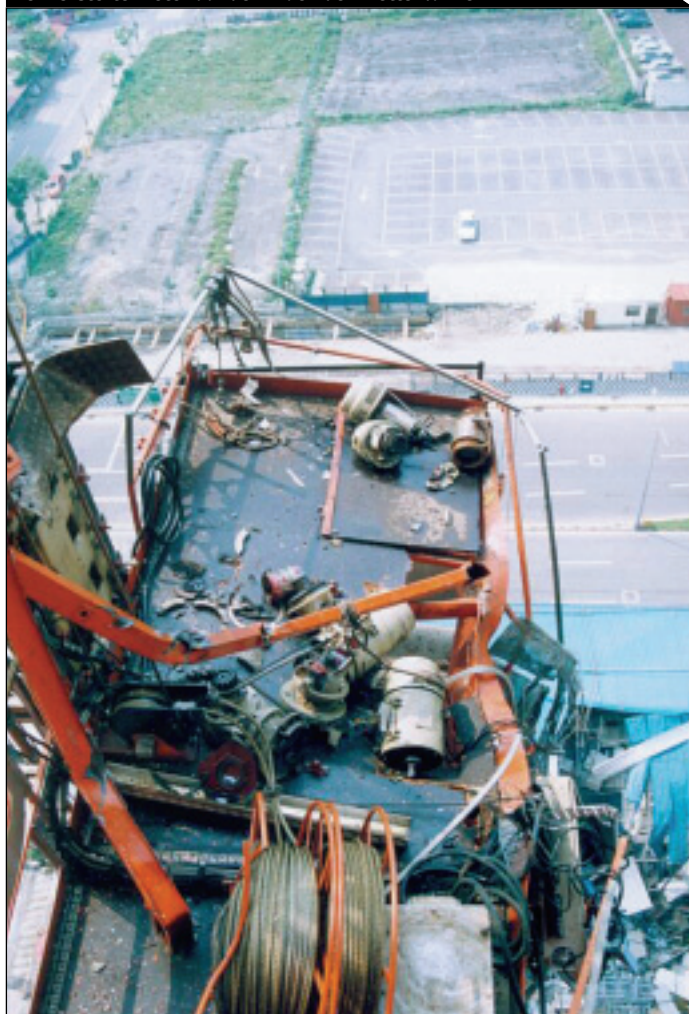
Der zerstörte Motor auf dem Dach der Kletterbühne
