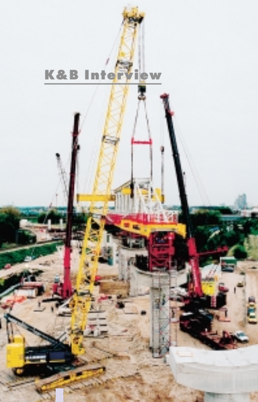
Zwei Demag AC650 und ein Demag CC2600 beim Bau der Bahnverbindung Utrecht zum Flughafen Schipol. Die Bahntrasse verläuft auf Stelzen.
