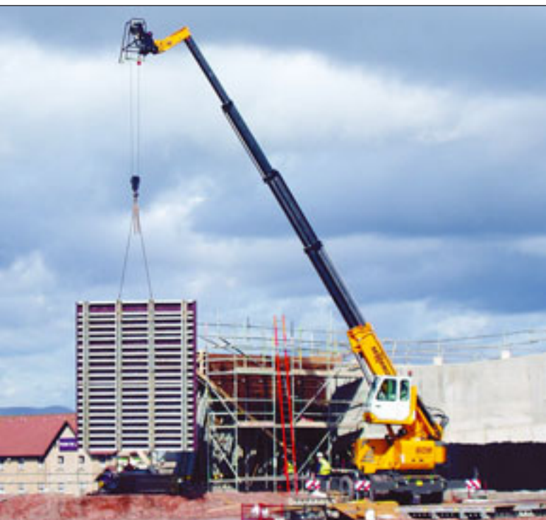
Im Rahmen von Brückenarbeiten in Schottland versetzte der Sennebogen 608 Multicrane 3,2 Tonnen schwere Sicherheitselemente. „Der 608 ist eine wirklich außergewöhnliche Allroundmaschine. Flexibel wie ein Mobilkran und wendig wie ein Telehandler. So können verschiedenste Aufgaben mit nur einer Maschine erledigt werden,“ so ein Sprecher von Morgan Est, das das Gerät speziell dafür angemietet hat.
