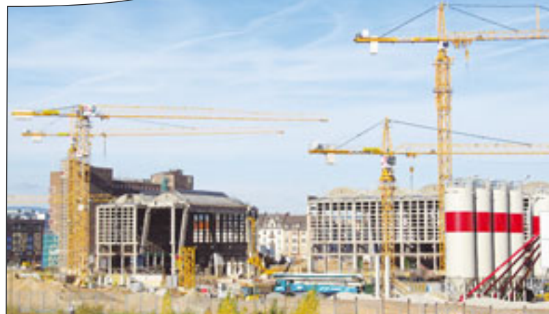
An der Baustelle der Europäischen Zentralbank in Frankfurt sind die Krane von BKL im Einsatz
