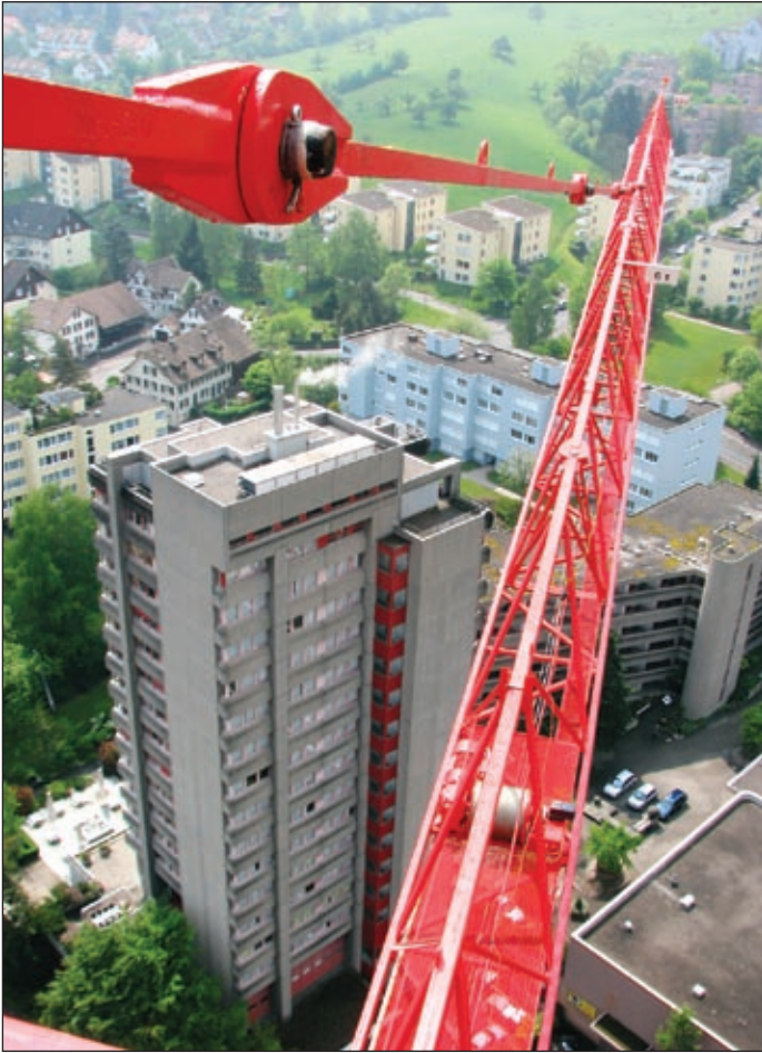
Montage eines Wolff 92 FL auf einem 60 Meter hohen Hochhaus in Leimbach bei Zürich. Der Kran wurde von Kaufmann Kranservice generalüberholt und umgebaut auf Frequenzumrichterantriebe
