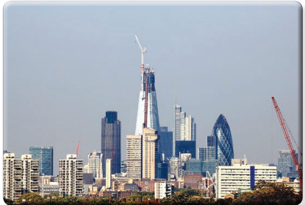
Insgesamt acht Terex-Krane sind beim Bau von Europas größtem Gebäude, dem Shard Tower in London, im Einsatz
