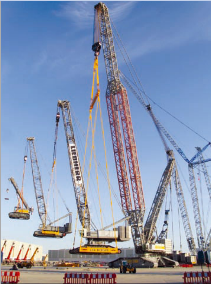
Ein Kran packt den nächsten am Haken, ein Mobile mit über 1.000 Tonnen Eigengewicht
