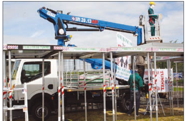
Big Astor mit seinem Fußgängertunnel, der Passanten vor herabstürzenden Teilen gut schützt. Im Hintergrund die CTE 20.13 MP
