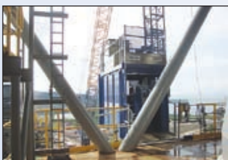
An den verschiedenen Etagen sorgen spezielle Etagensicherungstüren für einen sicheren Übertritt
