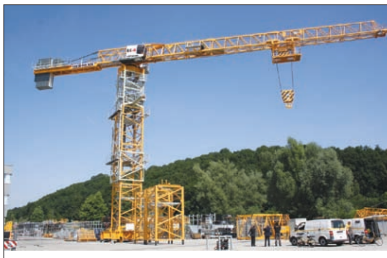
Auf der Baustelle des schwedischen „New Karolinsky Hospital“ in Stockholm werden mehrere EC-H-Krane eingesetzt
