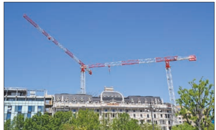
Terex-Krane halfen bei der Sanierung und Erweiterung des Excelsior Hotels Gallia in Mailand
