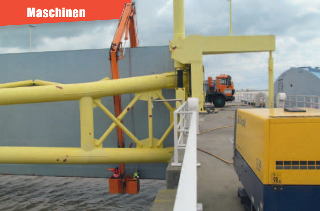
Zur Inspektion des Emssperwerks setzte Cramer seine NS28 ein, um so auch durch das Fachwerk einzutauchen
