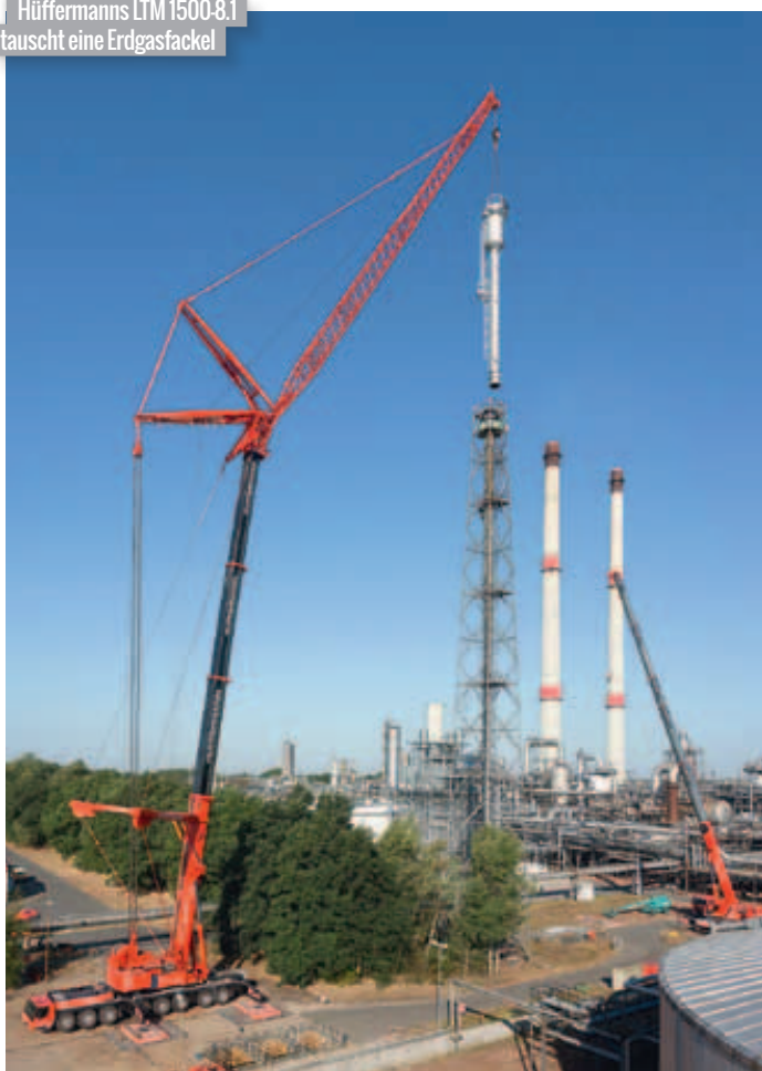
Bild für die Ewigkeit: 14 Grove-Krane, eine lange Leitung. Aertssen hob in Antwerpen im Synchronhub eine Pipeline, jeder Kran hat 6,1 Tonnen am Haken. Zum Einsatz kamen sieben GMK3055, drei GMK4080, zwei GMK5095 und zwei GMK5130-2.
