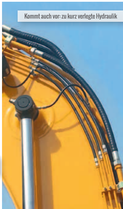
Ein klassischer Anwenderfehler: Der Biegeradius ist deutlich unterschritten
