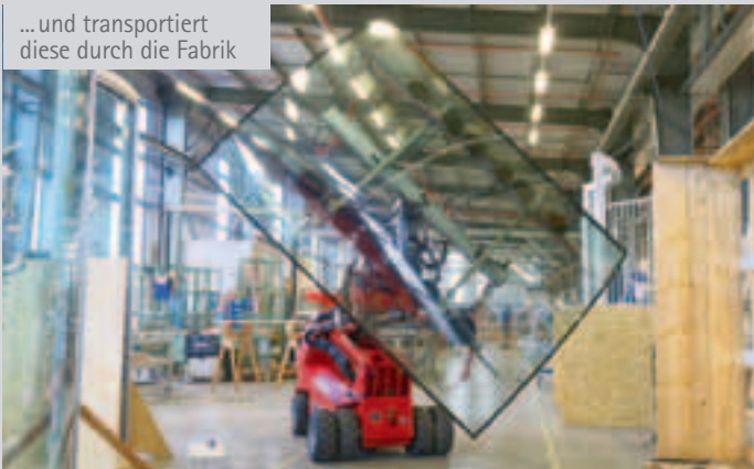
Auf dem unebenen Gelände der Baustelle verschafft sich der Minikran von Jekko einen festen Stand und hebt die Scheibe zum Einbauort
