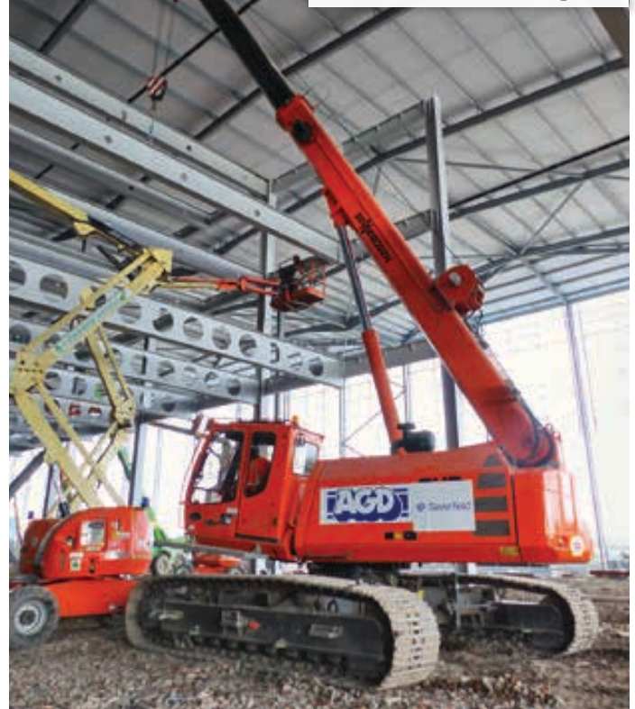
Neues Verpackungszentrum für Amazon im englischen Tilbury: Zwei Sennebogen 643 setzen die tonnenschwere Stahlträger
