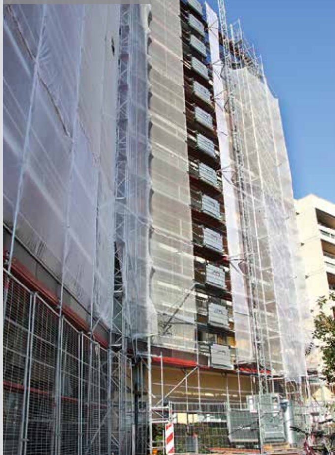
Der Zahnstangenaufzug Super-Lift MX 1024 von Böcker im Einsatz bei Sanierungsarbeiten am Wohnpark Gronau
