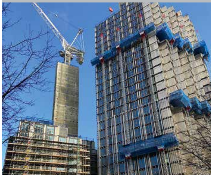
Arbeitsplattformen von Alba schmiegen sich der Gebäudeform des Londoner „Lewisham Exchange“ an
