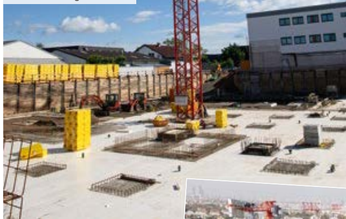
Erster Einsatz des neuen Großkrans BBL 8040.20/2 in Troisdorf, Neubau Büro- und Werkstattgebäude
