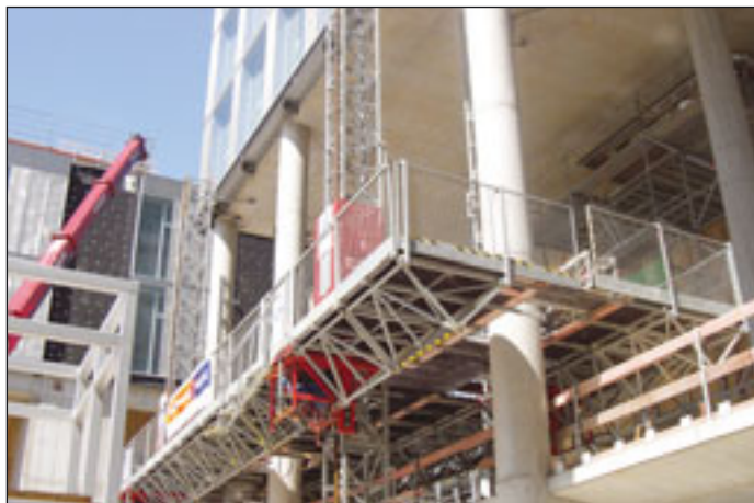
Alikak Hek zum ersten: Sonderkonstruktion, montiert um die Pfeiler, hinter die zwei Stahlträger eingefädelt wurden
